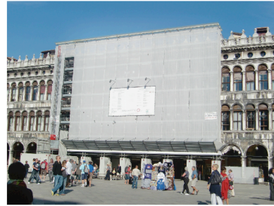
12世紀建設、16世紀改築 イタリア・ベニス サン・マルコ広場に面し 回廊の続く建築 「旧行政館」の改修工事 (2010年9月23日撮影)
